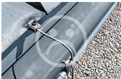
Paratonnerre Blocage de la bande à l'égout = fissures de dilatation dans les bandes
